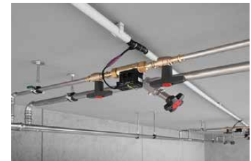
Wichtiger Bestandteil von GTS-Control: Elektronische Zirkulationsregelventile
