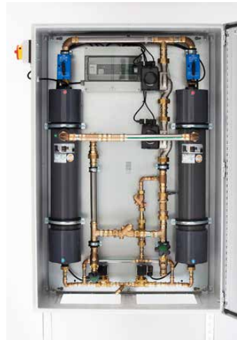
GTS-UF-Anlagen werden im abschließbaren Anlagenschrank ausgeliefert.
